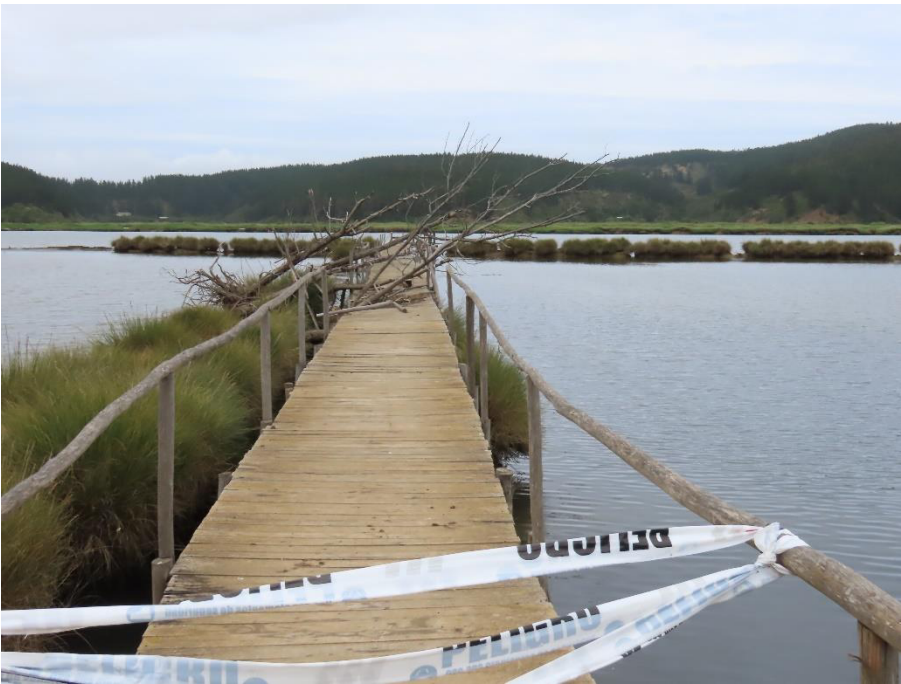
Camino obstruido hacia el Mirador del sector Barrancas.
