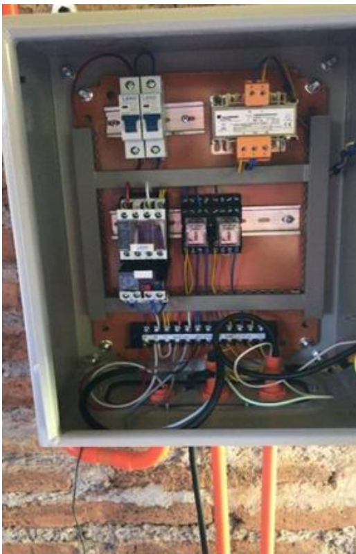
Foto 4 Caseta de bomba.
