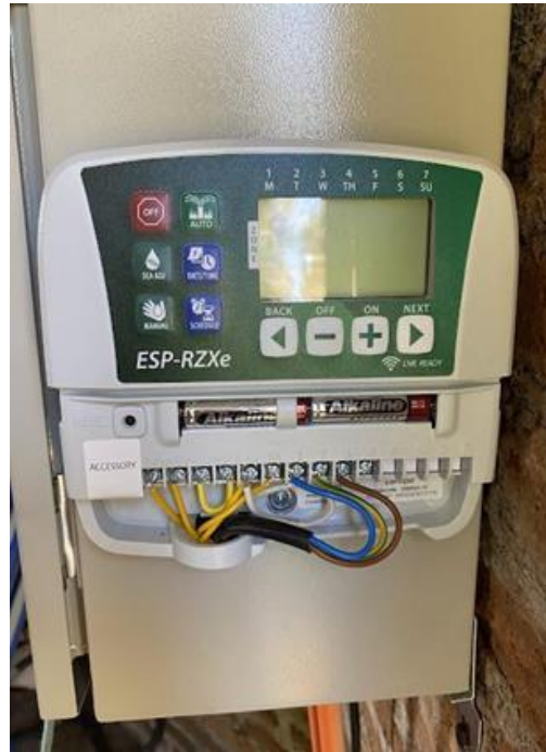
Foto 7 Programador sistema de riego
