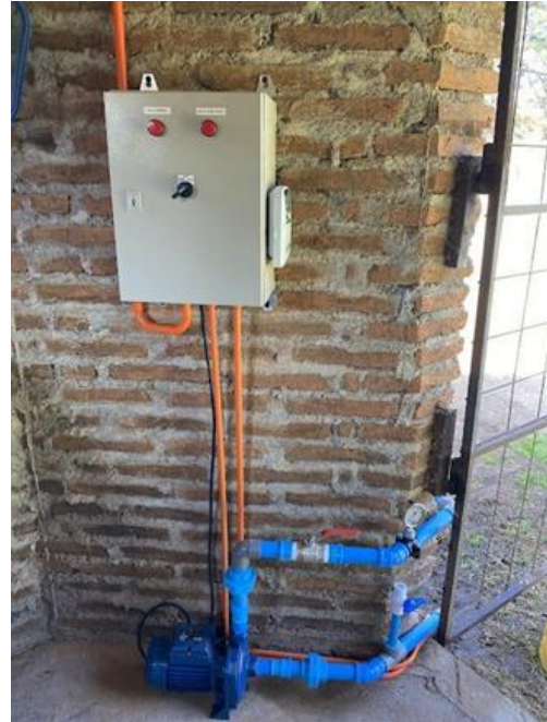
Foto 3 Caseta bomba y control de sistema de riego.
