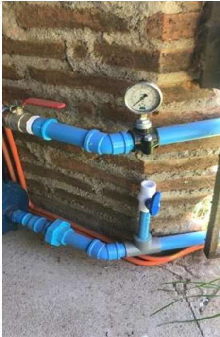
Foto 6 Manómetro e instalación cebado bomba
