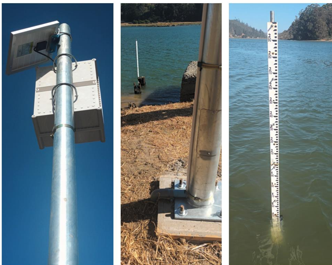
Figura 12 Detalle de la instalación, de izquierda a derecha: datalogger y panel solar, base de poste galvanizado y zona de cableado (enterrado/sumergido), y regleta de nivel.
