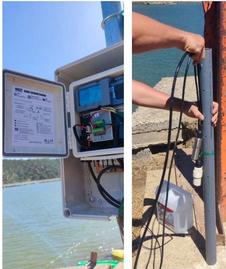
Figura 13 Detalle de la instalación, de izquierda a derecha: Interior de datalogger, y tubo de PVC perforado para resguardo de sensores sumergidos.
