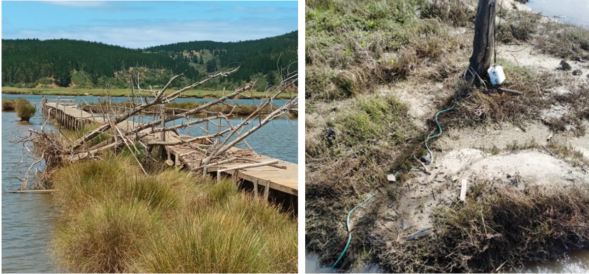
Figura 2 Izquierda: Pasarela en sector Barrancas dañada por árbol arrastrado por la crecida. Derecha: Estación de monitoreo dañada en sector Barrancas
